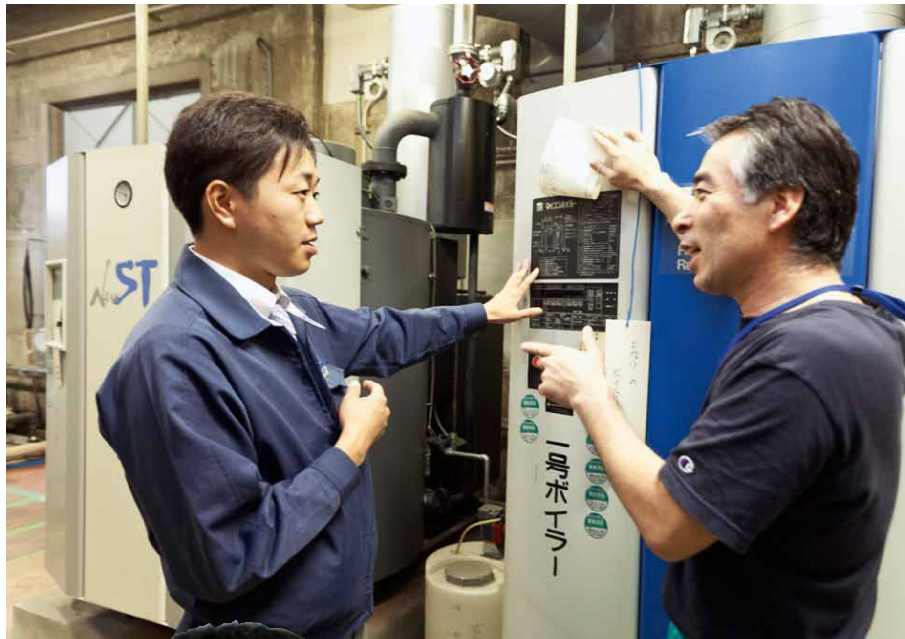
Sato Junichi vom Behindertenheim und ein Techniker vor dem kaputten Heizkessel.
