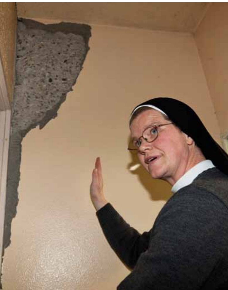
Das Beben hat im gesamten Kinderheim tiefe Risse hinterlassen.
